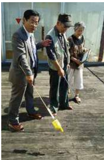
博多小学校を調査 (写真はウッドデッキの傷みを指摘)
